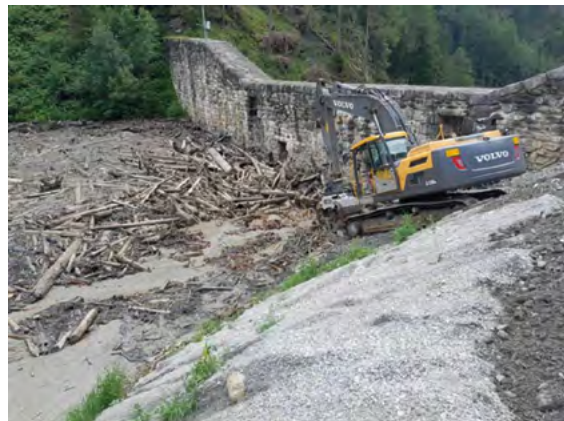
Die Murereignisse zeigten das hohe Gefahrenpotenzial des Bretterwandbachs.
